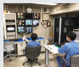
▲ 宝町中央監視室
