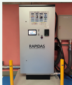
▲ 急速充電器(東京都板橋四ツ又駐車場)
