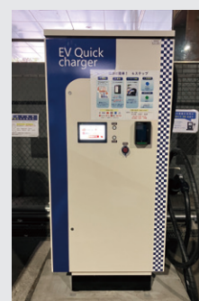
▲ 急速充電器（西新宿第四駐車場）
