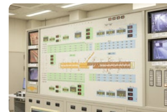
トンネル監視制御設備
