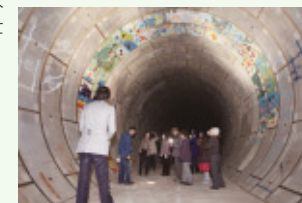
壁面に書かれた記号は補修の箇所を示すマークとか。
