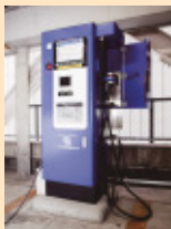
電気自動車用急速充電器を設置
