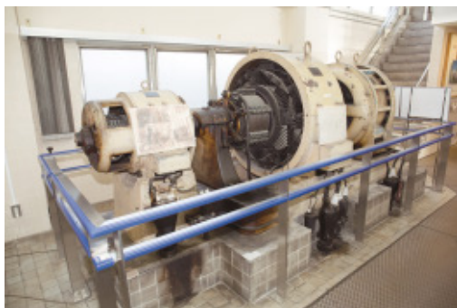
勝鬨橋を動かしていた変電設備
