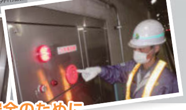
非常設備点検
