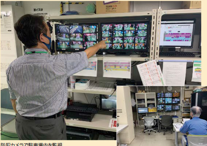
防犯カメラで駐車場内を監視
