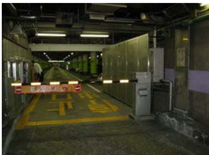
写真-3-3-8 進入禁止棒（モデル駐車場）
