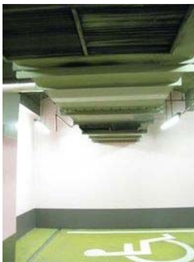
写真-3-3-11 照明装置（新京橋駐車場）
