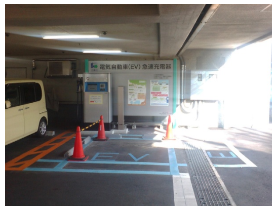
写真 2-3 江東区役所の設置例
