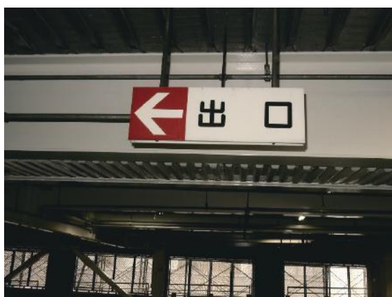
天井の誘導表示
