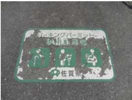
写真 8. 地面の表示が消えかかっている
