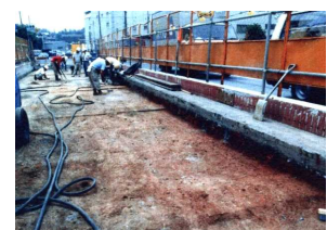
写真-3 BP腐食状態
