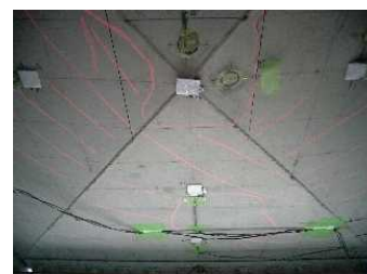
写真-5 BP-4.5S の下面はく離状態
