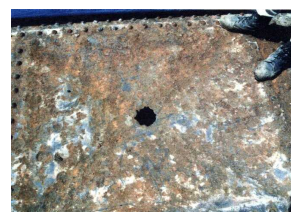
写真-2 水抜き穴の欠損
