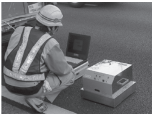
写真-4 CT メータ測定状況
