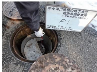
写真-6 貫井南町
