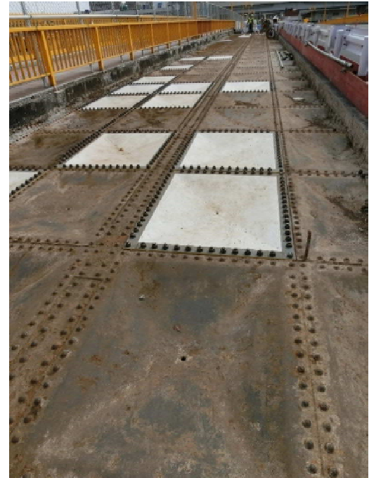
⑤腐食していたバックルプレート床版を長寿命化工事で交換した（白い箇所が交換箇所）
