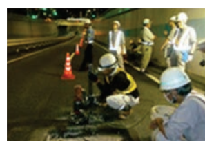
破損対策調査
